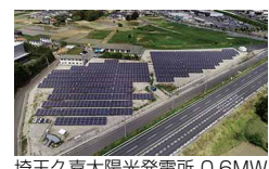
埼玉久喜太陽光発電所 0.6MW
